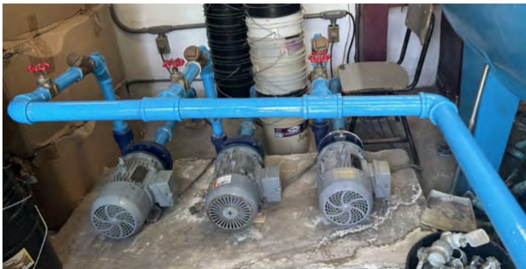
Figura 2. Sistema Hidroneumático de la Unidad Académica
