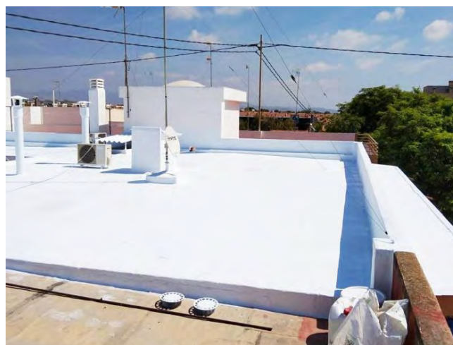
Figura 3. Techo reflectivo. Fuente propia.
