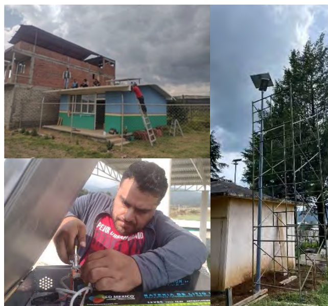
Figura 3. Implementación de sistemas fotovoltaicos en la comunidad de San Francisco Pichátaro en casetas de vigilancia, escuelas y panteón (CONACYT, 2021).
