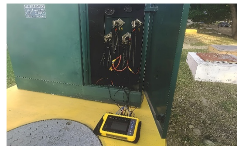
Figura 1. Conexión Analizador de la Calidad de la Energía 1775
