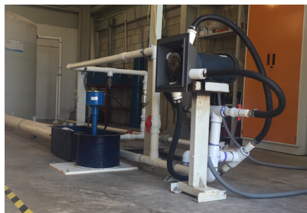
Figura 6. Sistema operación turbinas, CIATEQ, Cunduacán, Tabasco ( Proyecto CIATEQ)
