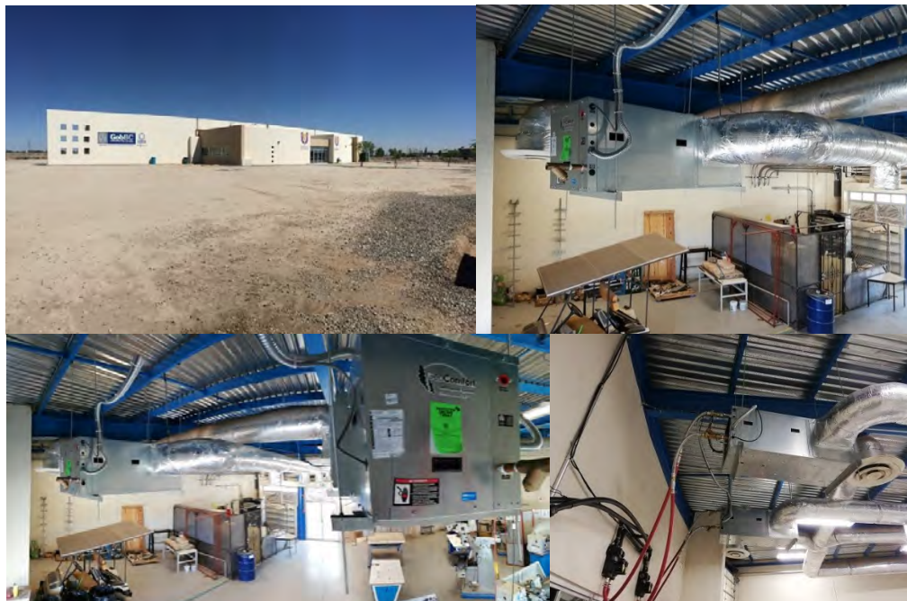
Figura 9. SBCG para laboratorios de UPBC, Bombas Horizontales, GeoComfort
