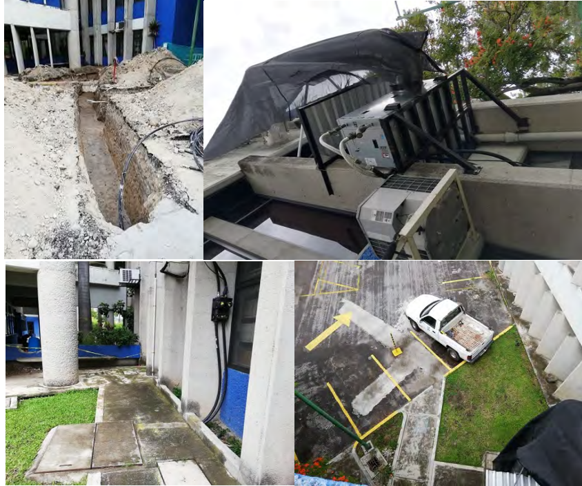
Figura 10. SBCG para sala de juntas del INEEL, Bombas Horizontales, GeoComfort
