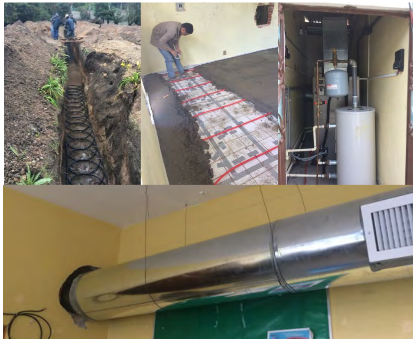
Figura 8. SBCG para Clínica IMSS, combo bomba Vertical, GeoComfort
