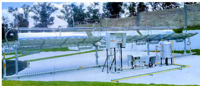
Figura 1. Instalación termosolar con arreglo de CCPs con orientación N-S y seguimiento solar E-W, ubicada en CIATEQ Jalisco (20.719°, -103.426°)
